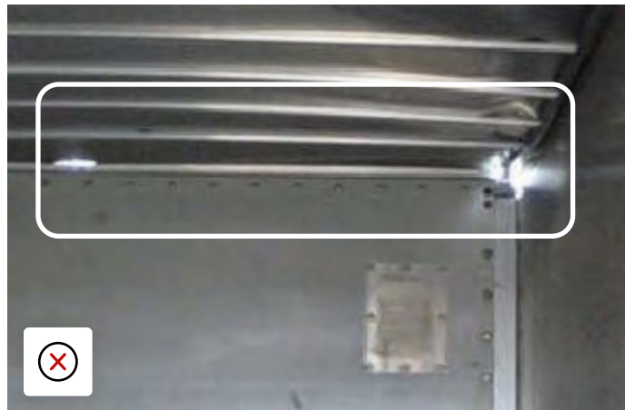
Skade på fremre takplate
