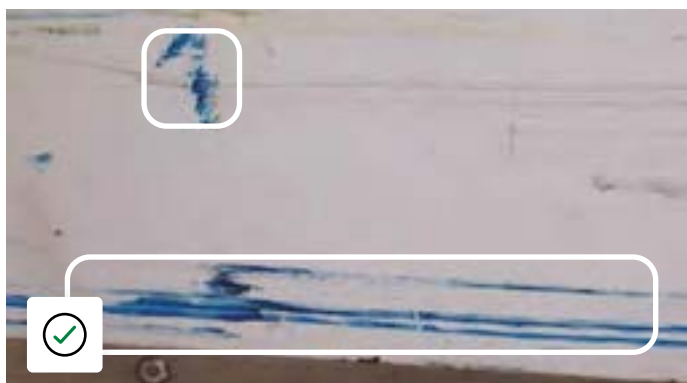
GRP-panel skrappt av paller, men ikke penetrert Gelcoat.
