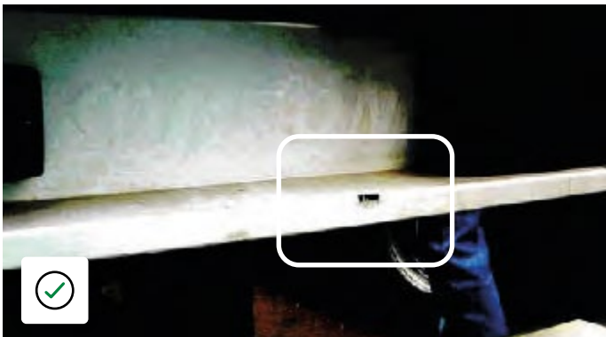
Slagskader som ikke forvrenger fabrikasjonen, og som kan rengjøres og lakkteres uten store kostnader.
