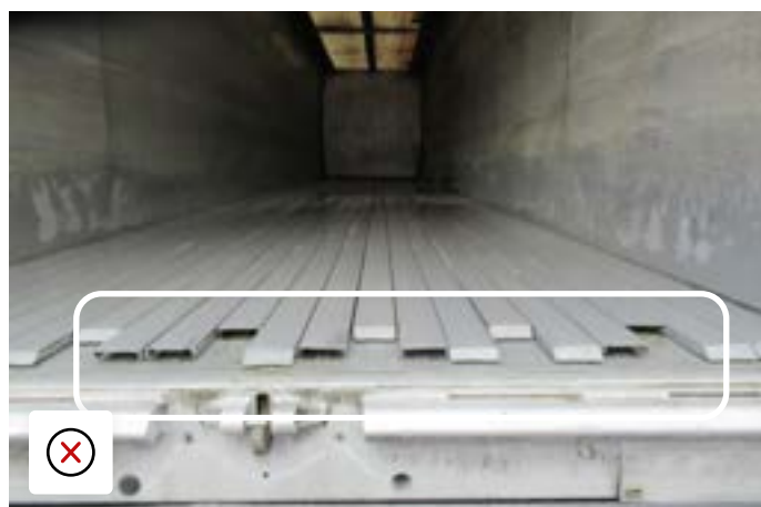
Stangkantene mangler - varer kan falle under gulvet
