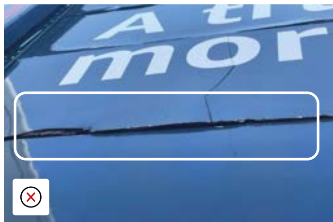
Dørpanel på rullesjalusi sprukket på grunn av støt
