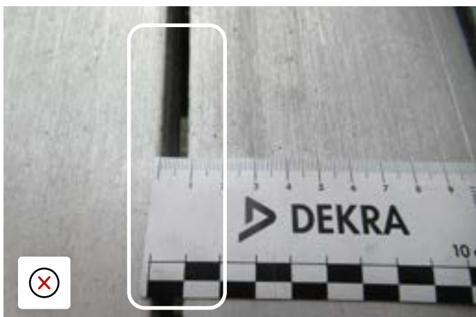
Gulvbord spredt og ikke sikre for transport - varer kan falle gjennom gulvet
